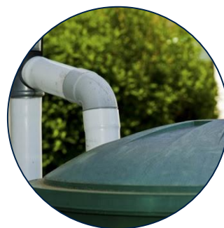
Récupérateur d'eau pluviale
